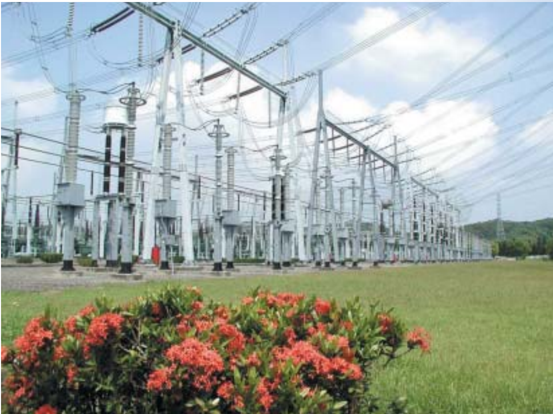
峨嵋345KV開關廠
